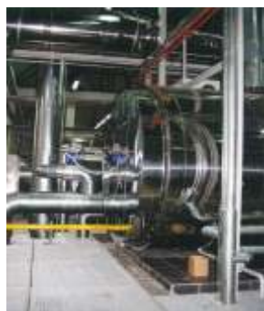
Caldaie per carico di punta
