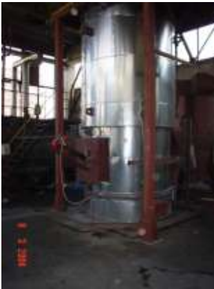
Abb.: Mit Holzbriketts befeuerter Heizkessel
