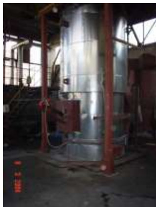
Photo: la chaudière à briquelettes de bois
