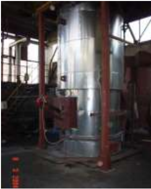
La caldaia alimentata a bricchetti di legno
