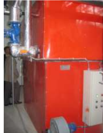
Abb.: Mit Holzhackschnitzeln befeuerter Heizkessel
