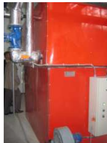
Caldaia a cippato di legno
