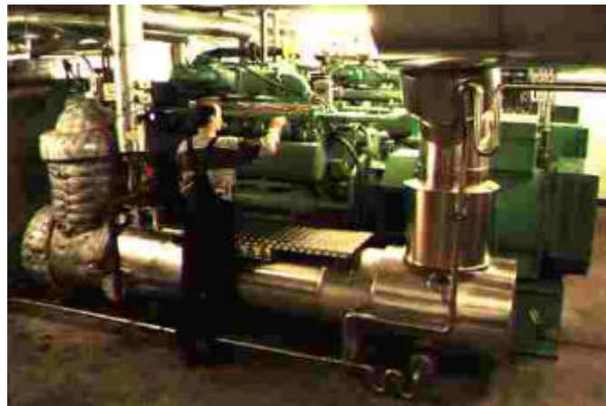
Figure IV-I: Co-generation unit „Palmengarten“
